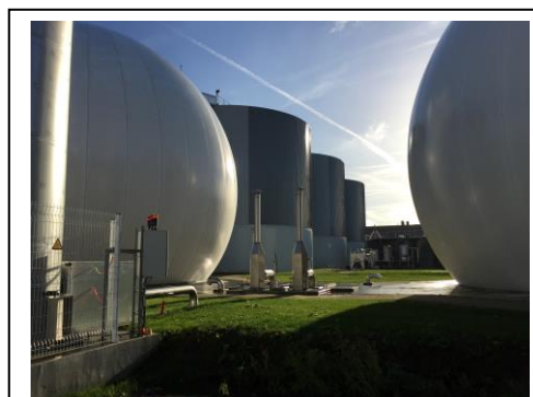
Biogas tanke fra andet anlæg
