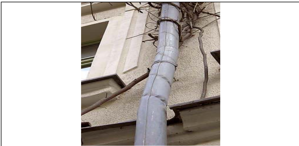
Figur 2.2 Nedløbsrør deformeret af blåregn ( Wisteria )
